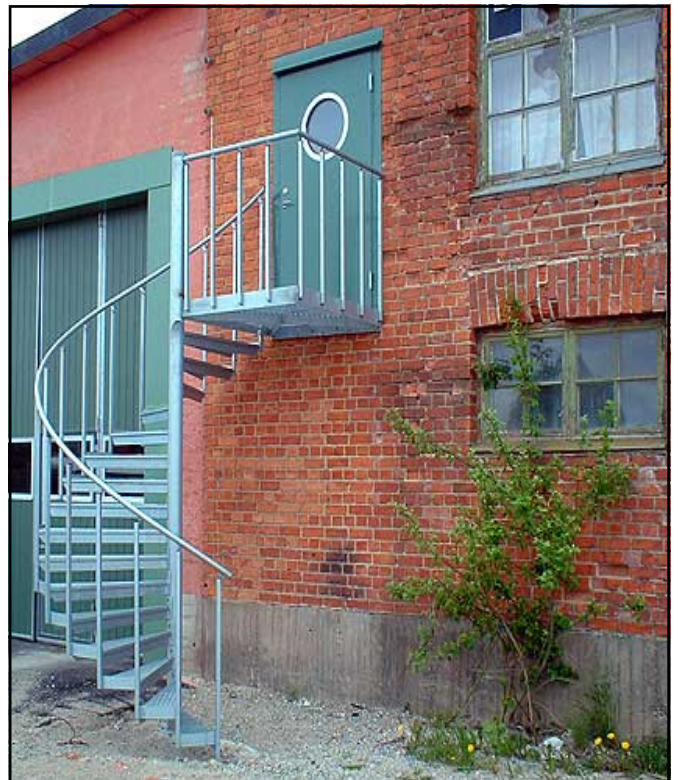
Ohlssons Maskinservice, Vingåker. Spiraltrappa i industrimodell med avstigningsplan och planräcken. Steg av gallerdurk, handledare och räcke av stålrör, varmförzinkad.
