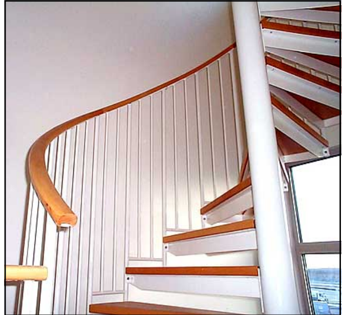
Cargo Center, Arlanda. Förlängning av befintlig trappa. Steg och specialhand- lare av massivt trä, trappräcke med barnsäkert stålgalleri, pulverlackerad.
